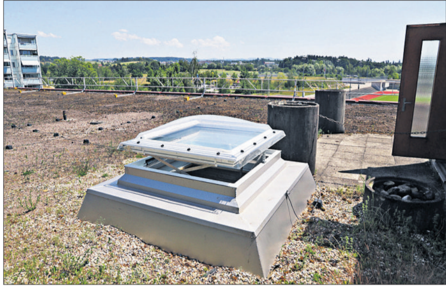
Die warme Luft strömt von 20 Uhr abends bis 7 Uhr morgens über drei grosse Dach-Oberlichter nach aussen. . Bilder: Beatrice Zogg
